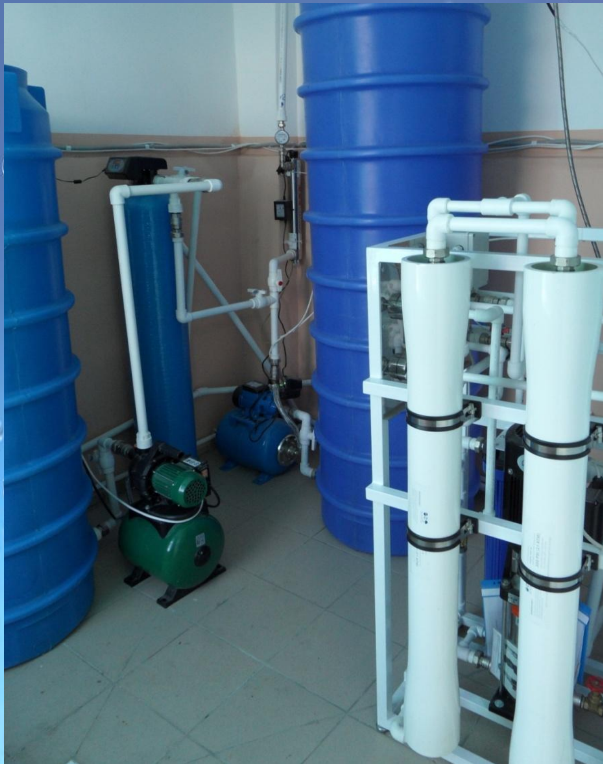
Действующие установки АФС- М Омская область, Русско-Полянский район, с. Новосанжаровка
