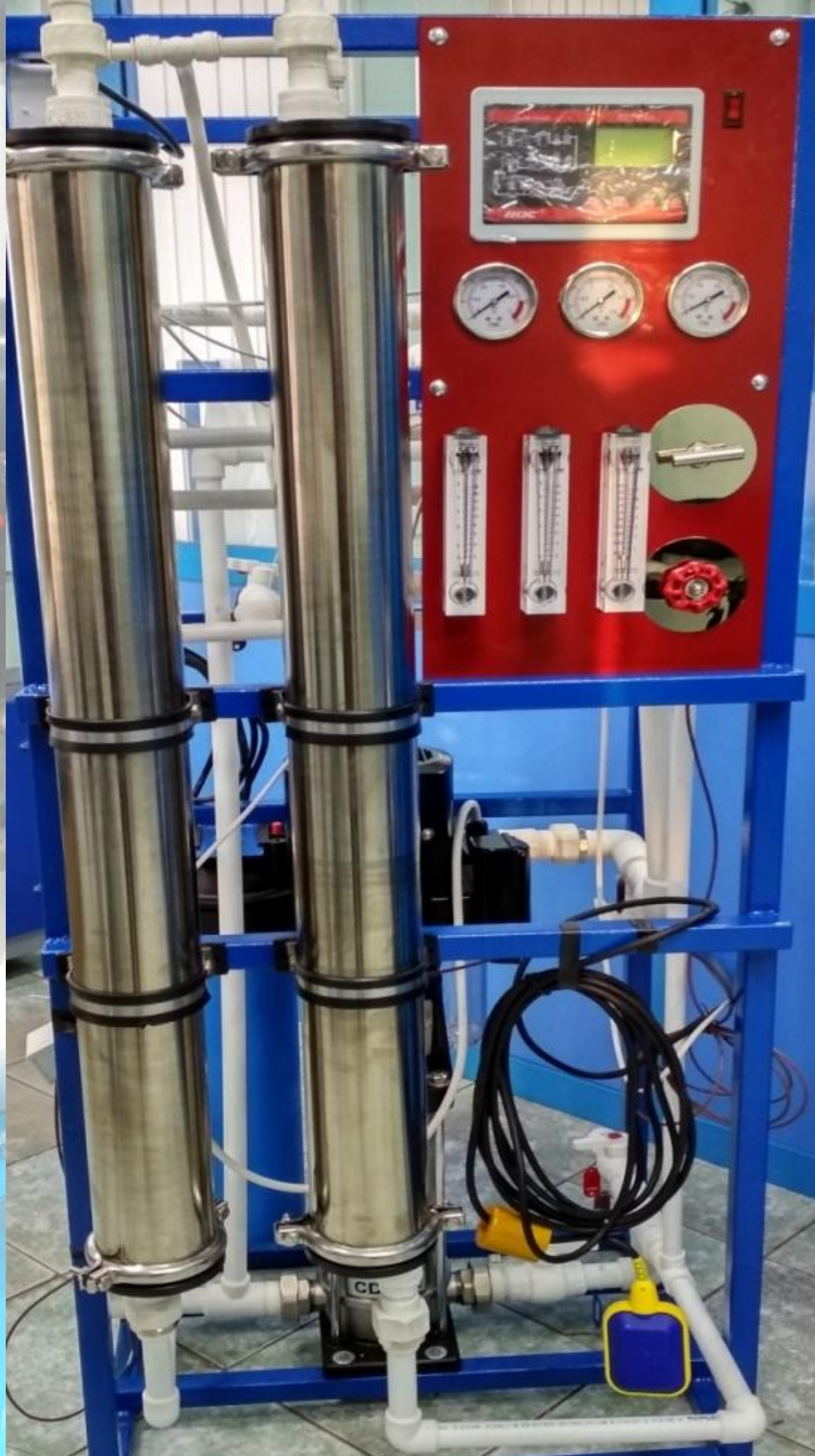
Модуль тонкой очистки установки АФС-М
